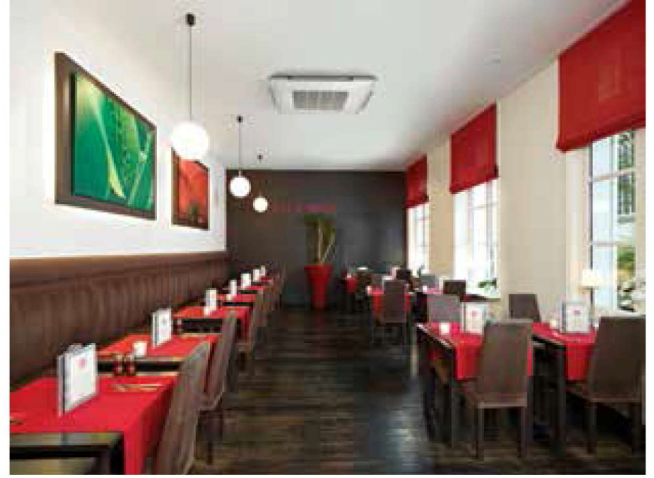
Αναρτώμενες μονάδες οροφής
